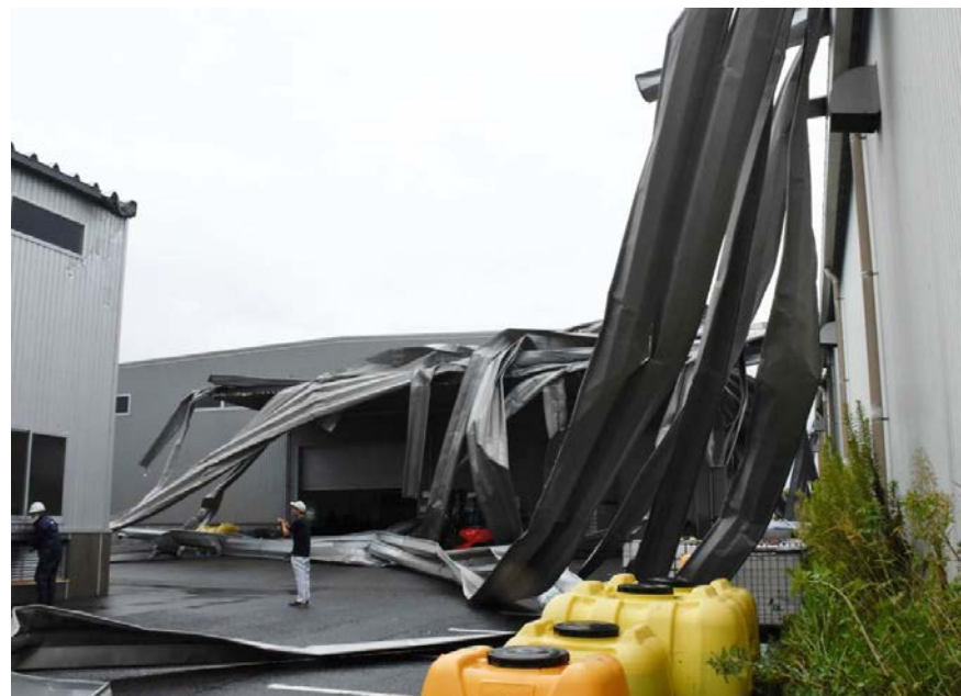
宮崎テクノリサーチパークでは工場や倉庫の屋根が剥がれたり、事業所の窓ガラスが割れたりした。28日午後2時40分、宮崎市佐原町東上那珂(中西透撮影)
